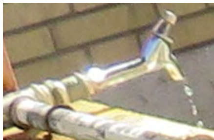
شکل ۱ - نمونه ای از نشتی شیر فشاری نصب شده در جایی که فشار آب شهر پشت آن است.
